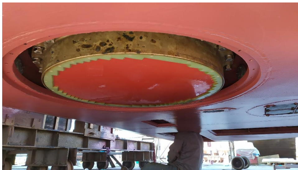
Figura 2.- Transductor de perfilador acústico de corrientes (ADCP) instalado en la cara inferior de la góndola.
